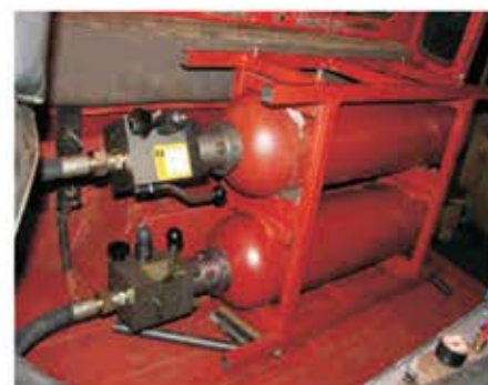
Fig. 5 Bateria de acumuloare hidropneumatice
